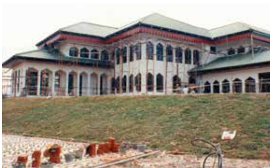
Pengubahsuaian bangunan Pejabat Yayasan di Jalan Kumbang Pasang (kini dinamakan Jalan Perdana Menteri)
